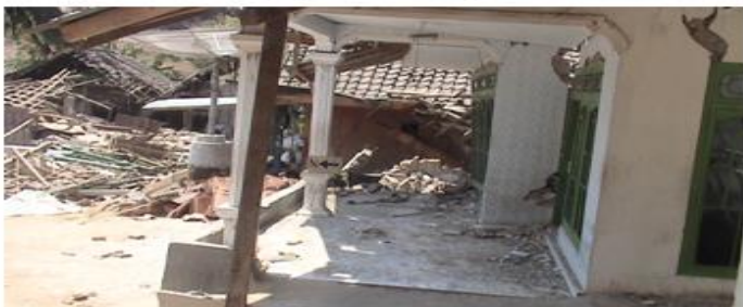
Gbr 9. Kerusakan Rumah di Dukuh Boto Kodung, Dusun Cerpap, Desa Kedunglo
