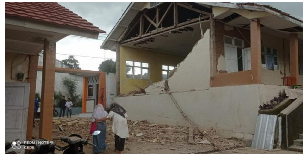
Struktur kolom & balok kuat tetapi dinding lemah
