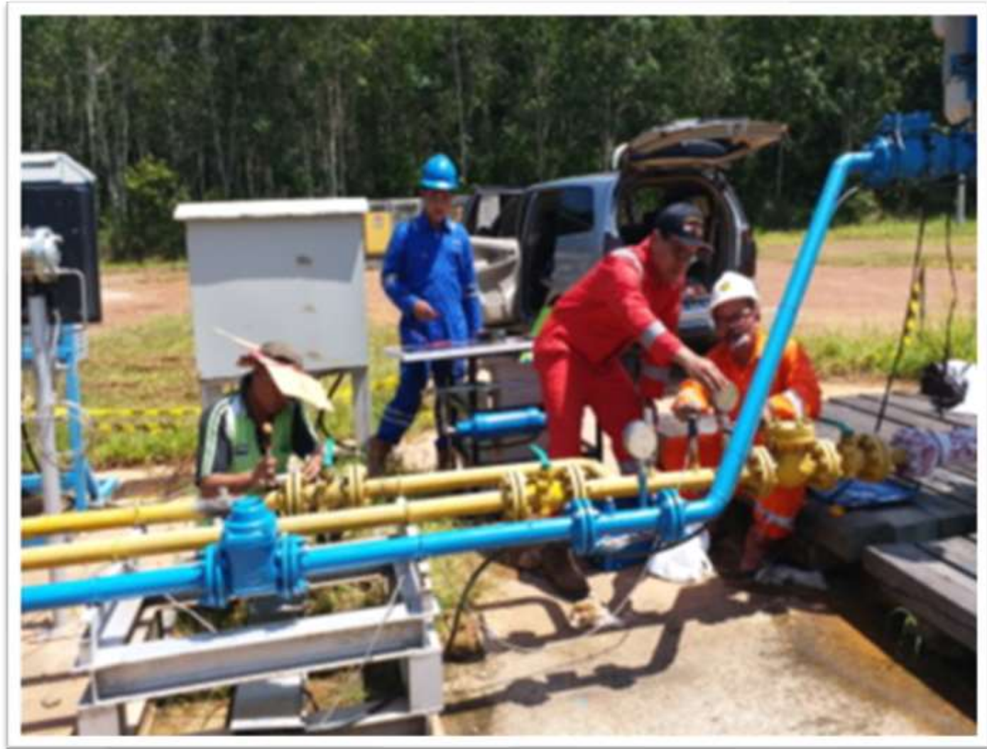
WSS untuk Pengontrolan dan monitoring pada Produksi Coalbed Methane (Pertamina Hulu Energi– Tanjung Tabalong Kalimantan Selatan)
