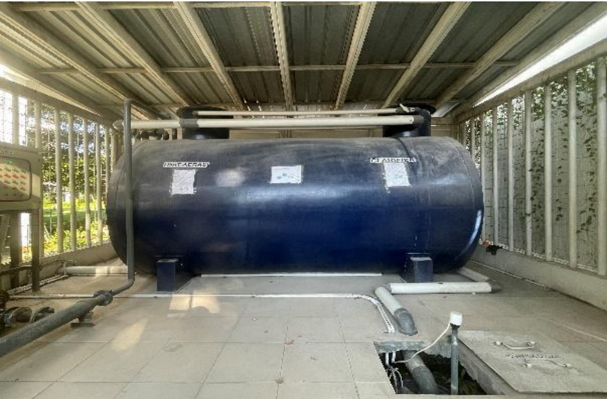
IPAL untuk mengolah limbah grey water dari toilet di Gedung Rektorat ITS
