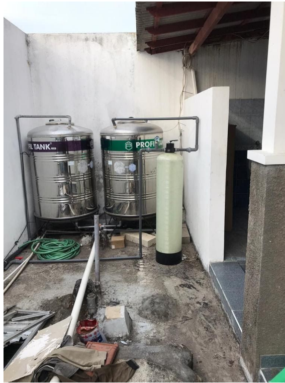
Instalasi Pendukung Kran Air Siap Minum
