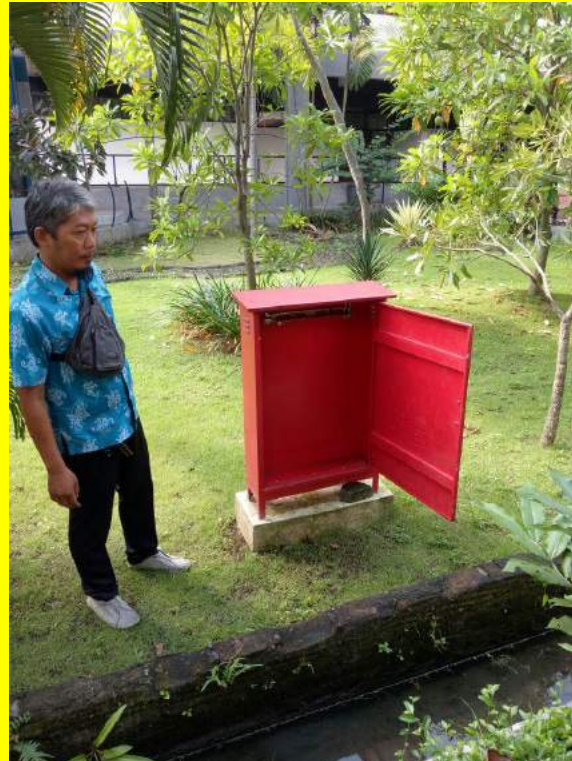
Pipa dan Nozzle Hydrant
