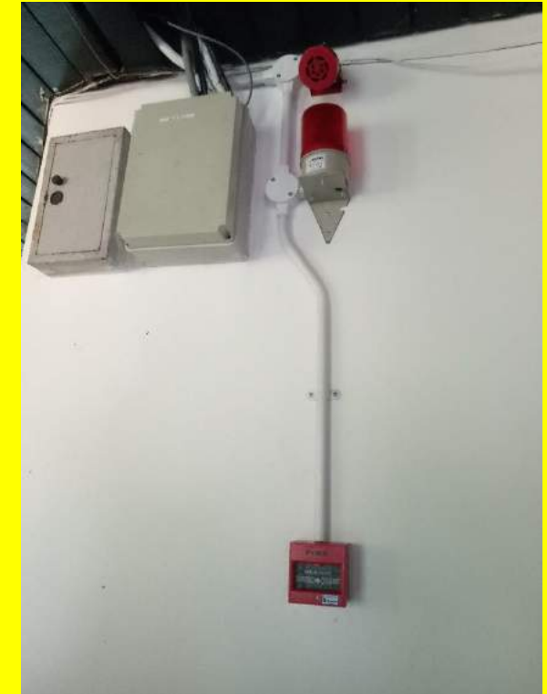
Sensor Asap dan Alarm
