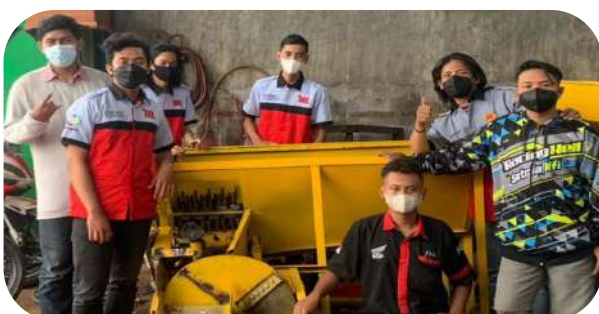
Gambar 3.7 Tim KKN Abmas Saat Melakukan Repair Dan Pengecatan Ulang TTG Pencacah Sampah Balistik
